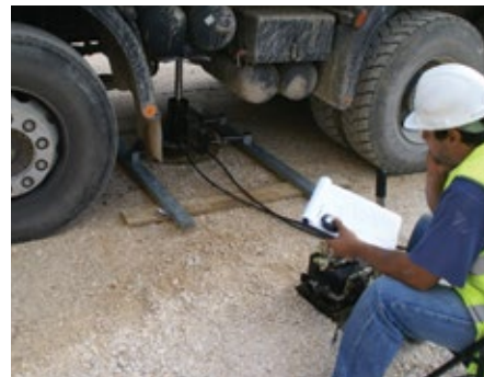
Execução de ensaios com placa para verificação da plataforma de apoio de uma grua automóvel (fonte: OE)
